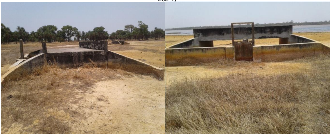
Planche 9 : barrage abandonné par manque de renouvellement de la Dig ue à Karongue (Cliché Sané, 2024)
