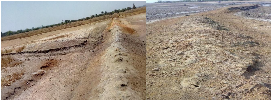
Planche 8 : digues détériorées par manque de renouvellement dans la vallée de Birkamading (Cliché Sané, 2024)
